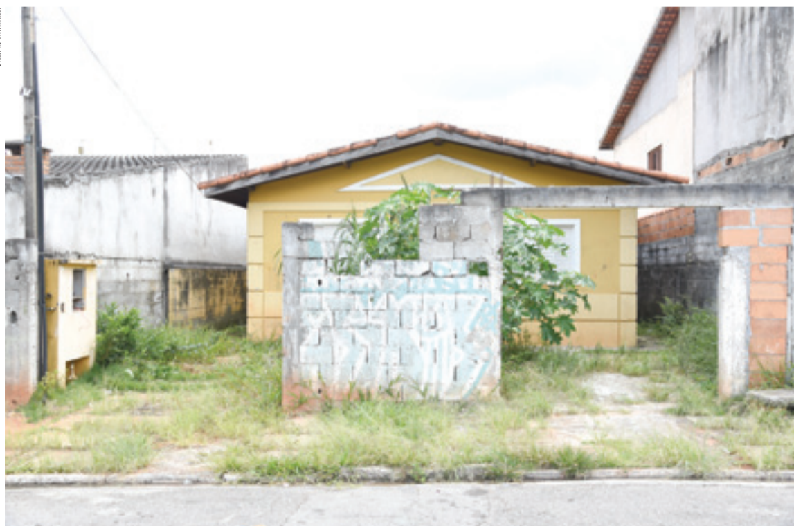
Local, que está sendo alvo de reclamações, já recebeu muitas por falta de muro e calçamento
